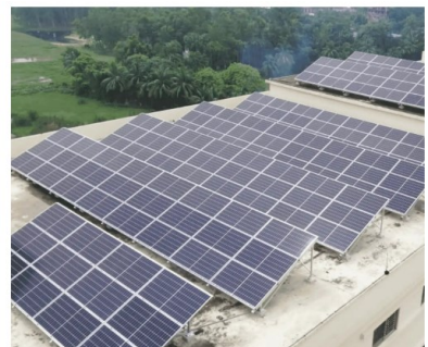
상업용 및 산업용 태양광 지붕 서비스 (Commercial & Industrial Solar Rooftop Services)
